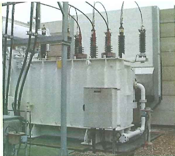
Transformateur en loge
