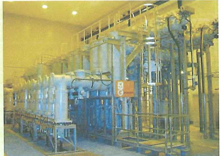
Un poste sous enveloppe métallique
